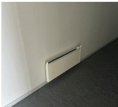
Figur 28 OKT74 – paneloven i flere plasser på bygge
